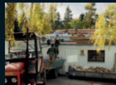
Oprava střechy na pavilonu šelem Repair of the roof of the carnivore house
