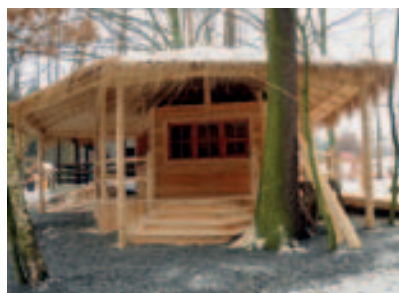
Stavba nového občerstvení u východu ze zoo Construction of the new refreshment shop at the exit from the zoo
