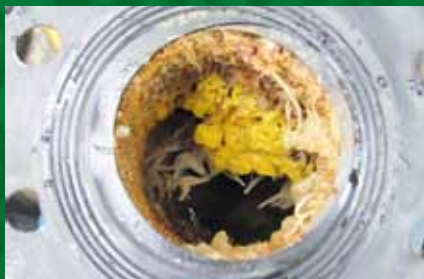
„Zarostlá“ odtoková trubka /“Overgrown” drain pipe/
