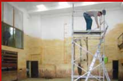
Oprava nátěrů v pavilonu žiraf /Repair of paintwork in the pavilion of giraffes/
