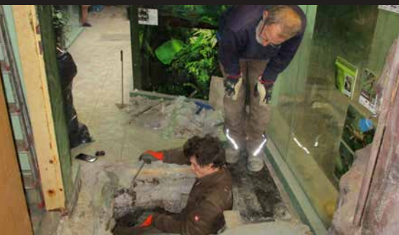
Oprava kanalizace v Jihoamerickém pavilonu /Repairing of sewerage in South American pavilion/
