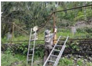
Odstraňování následků víchnice /Removal of storm debris/
