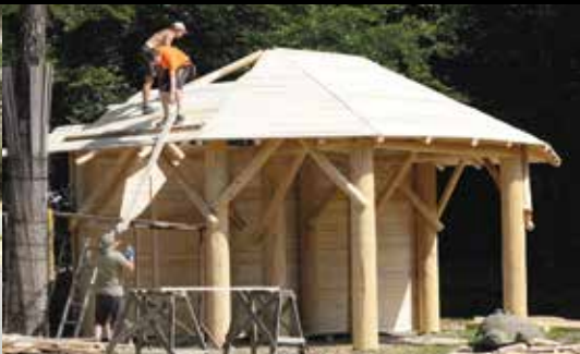
Stavba altánu ve výběhu velbloudů /The construction of the gazebo in the camels' paddock/
