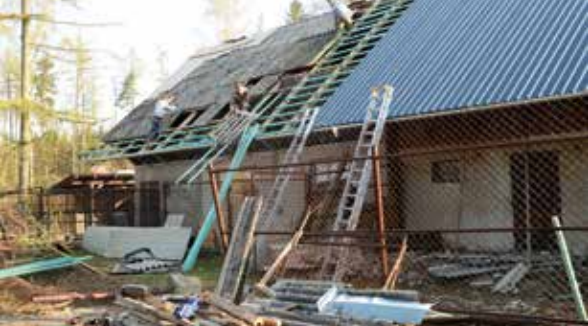
Oprava střechy na stáji pakoní /Repairing the roof on the wildebeest shelter/
