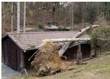
Vichřice poničila i řadu střech /The storm destroyed a number of roofs/
